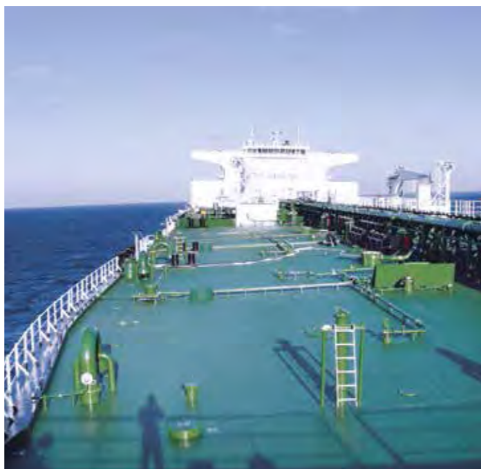
Voll automatisierte ELWA Kraftstoffversorgungen für Supertanker (Booster-Module)
